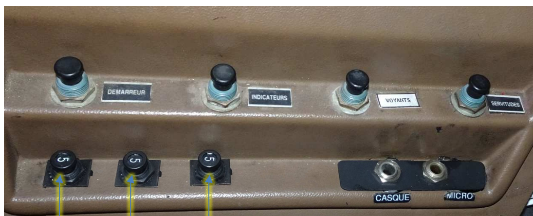
Détail du panneau porte-fusibles gauche (N° 45)
